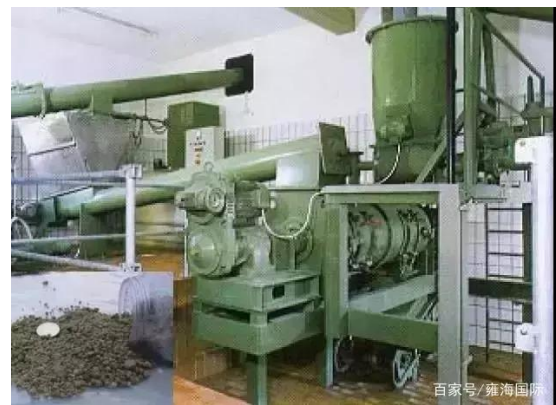
配备石灰加料系统的混合器
