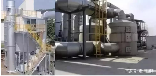
蓄热式固废焚烧系统
